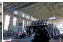
Subestación de Quevedo
