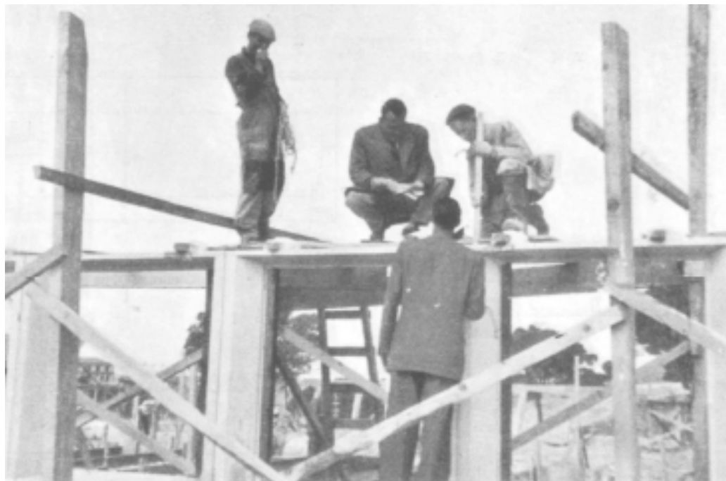
Fase de hormigonado entre cercos de ventanas. Prefabricación, Especial Eduardo Torroja, Informes de la Construcción, vol. 51, n° 462, p.49, Madrid, 1999.
