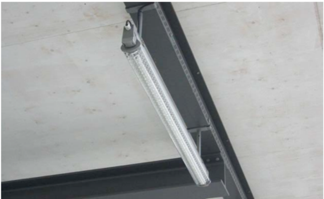
Luminaria fluorescente. Estación de Emmenbrücke, Lucerna
