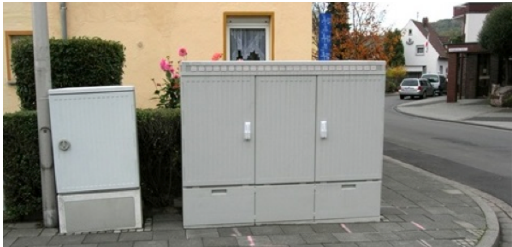
Armario de intemperie con equipo ADSL en una calle de Alemania.
