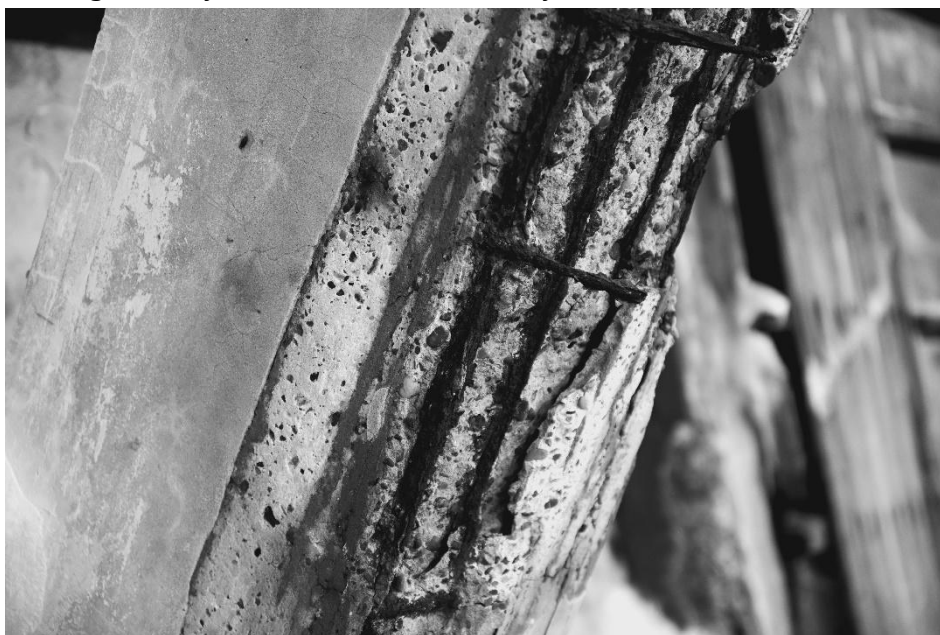
Figura 6. Detalle de una parte del arco afectada por la corrosión de las armaduras, como consecuencia del fenómeno de carbonatación. (Foto: Ilaria Campese).
