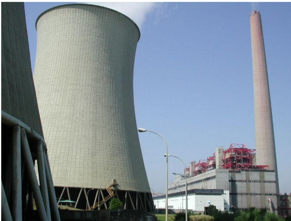
Figura 7. Torre de refrigeración y chimenea. (Fuente: Endesa generación).
