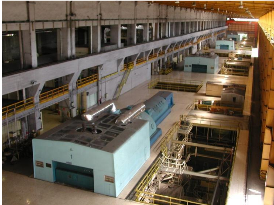
Figura 6. Nave de turbinas. (Fuente: Mantenimiento de una gran instalación industrial. Endesa generación) (Endesa generación, 2010).
